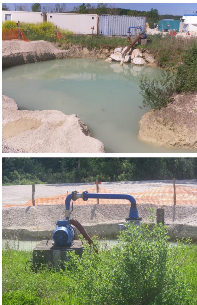
Figure 12 : Bassin de pompage et pompe utilisée pour l'alimentation de l'installation de lavage des matériaux (ENCEM)
