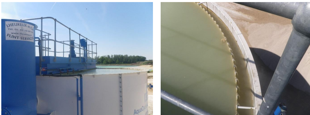
Figure 9 : Réservoir épaisseur et rigole de rejet des eaux clarifiées (ENCEM)
